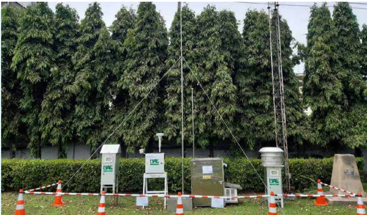
การติดตั้งเครื่องตรวจวัดคุณภาพอากาศภายในพื้นที่ก่อสร้าง
